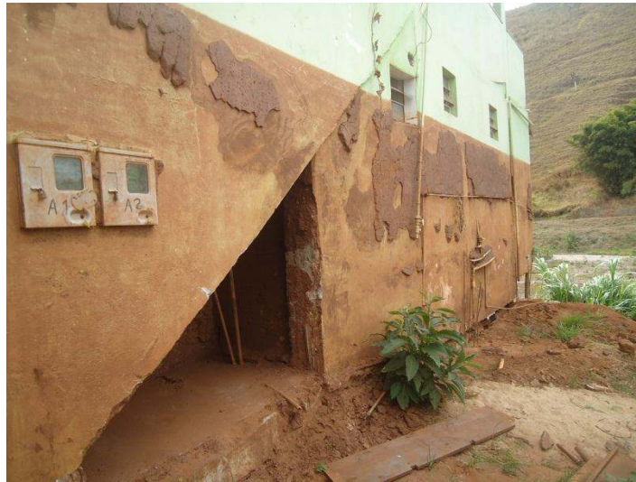
Figura 6 - Imagem mostrando residência em Barra Longa (MG), que ainda guardava, em 22 de setembro de 2017, as marcas da lama.
