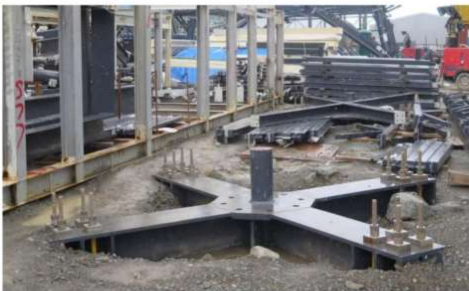
• No verão, os trabalhos de construção seguem a todo vapor Foto: Monica Gugliano
