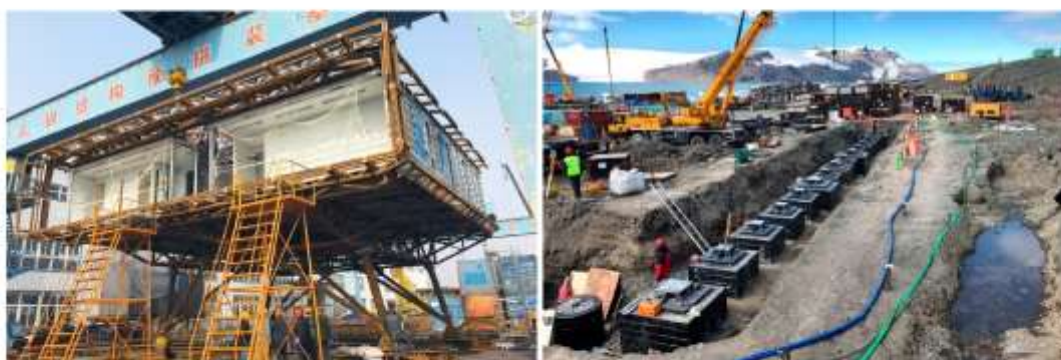
Um 'mockup' (modelo) da nova Estação Antártica Comandante Ferraz, em tamanho natural, foi montado para testes em Xangai; à direita, obras de fundação na Antártida; - (Divulgação/Celec e Marinha do Brasil)
